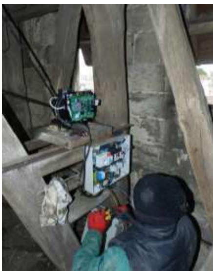
Remplacement du moteur de volée de la cloche
